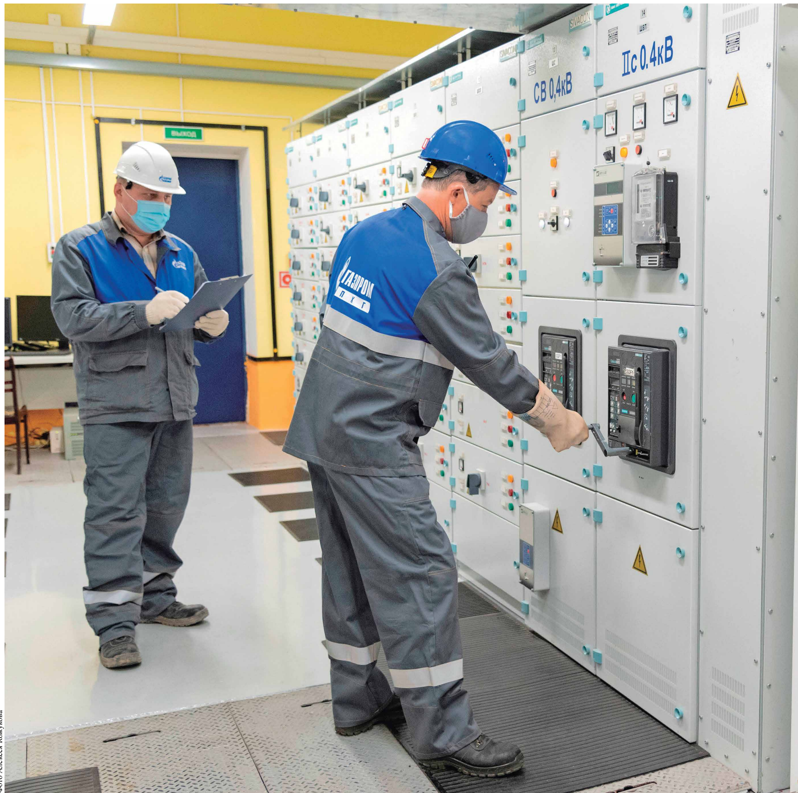
Калининградское УПХГ. Энергетики службы ЭВС производят подготовку оборудования для допуска бригады к работе в комплексной трансформаторной подстанции
