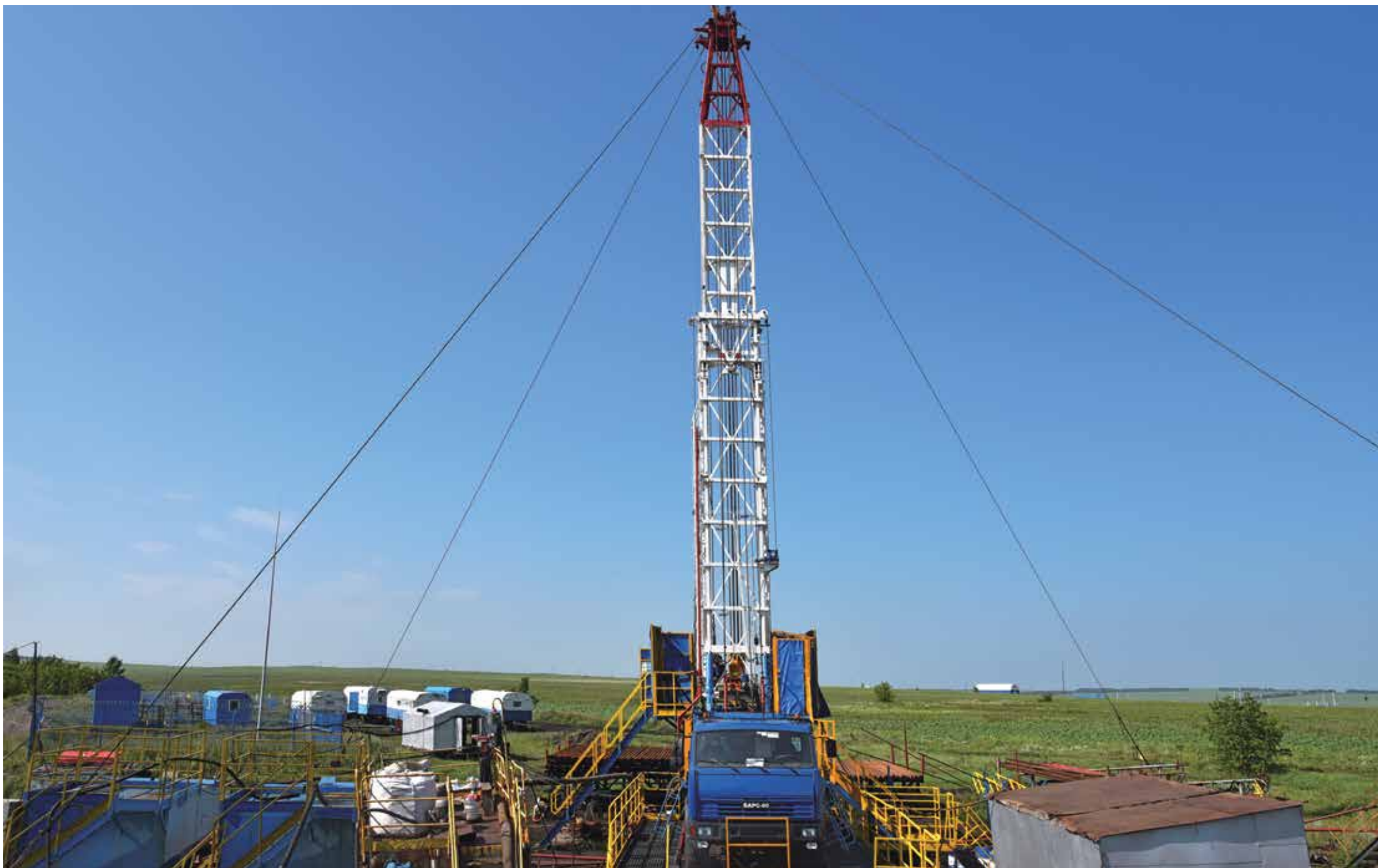
Установка «Барс-80» на объектах Канчуринско-Мусинского комплекса ПХГ
